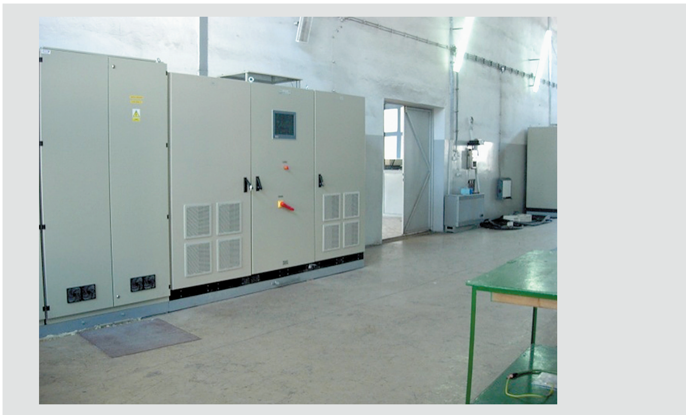
Rys. 8. Widok pracującego układu filtra aktywnego Xinus D-IMVAd i baterii kondensatorów o mocy 1 MVar
