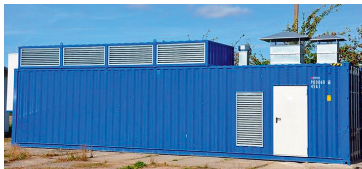
Fot. 1. Widok jednego z kontenerów wchodzącego w skład magazynu energii
